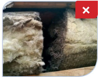
Nedokonalé spojení izolace
