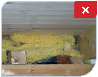
Nedořešené detaily, kudy uniká teplo
